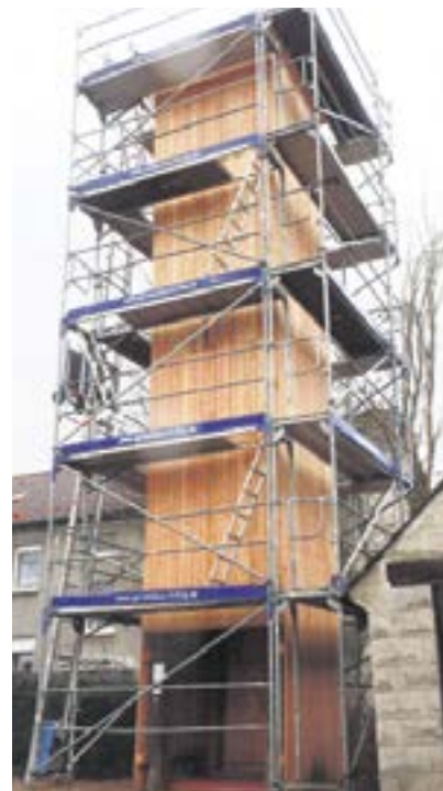
Der Spritzenturm in Kossa ist eingestüst. Foto: (Wsp) Nyari
